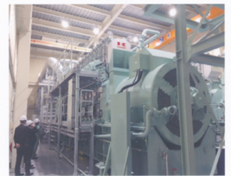
富士発電所内
